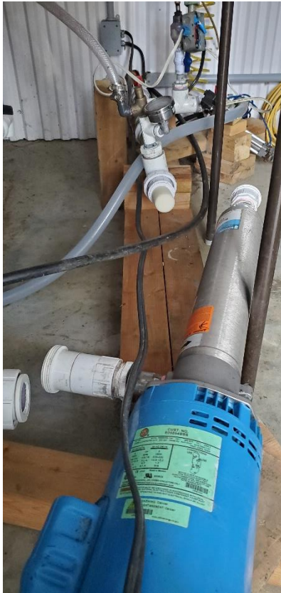
Connecteur rapide après pompe de refoulement
