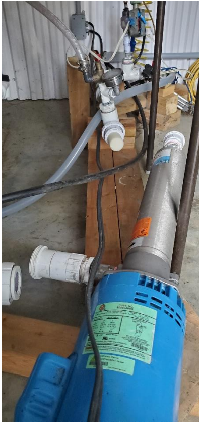
Connecteur rapide après pompe de refoulement
